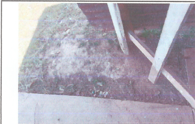
Foto 1: REGLAS EN MAL ESTADO A PUNTO DE CAER
