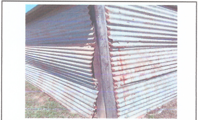
Foto 2: LÁMINA DE BODEGA EN MAL ESTADO Y LA PUERTA.
