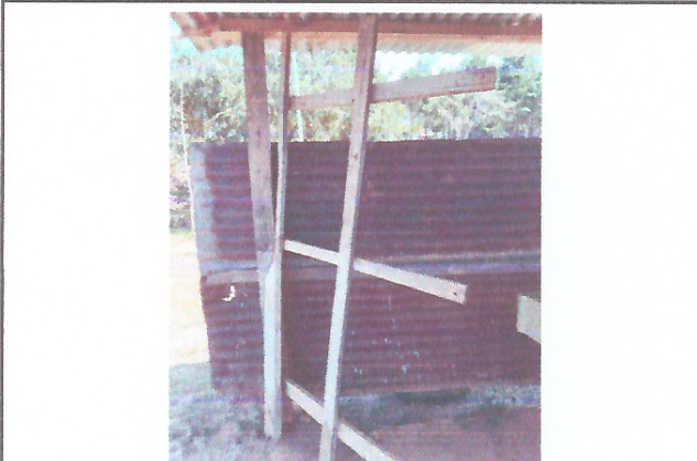
Foto 4: REGLAS Y LAMINAS EN MAL ESTADO
