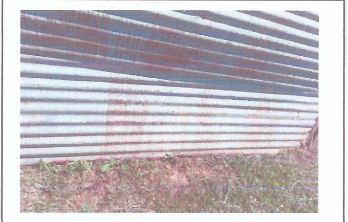
Foto 4: LAMINAS EN MAL ESTADO POR EL AGUA
