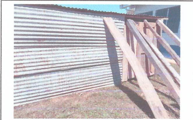
Foto 1: LAMINAS PICADAS Y EN MAL ESTADO.
